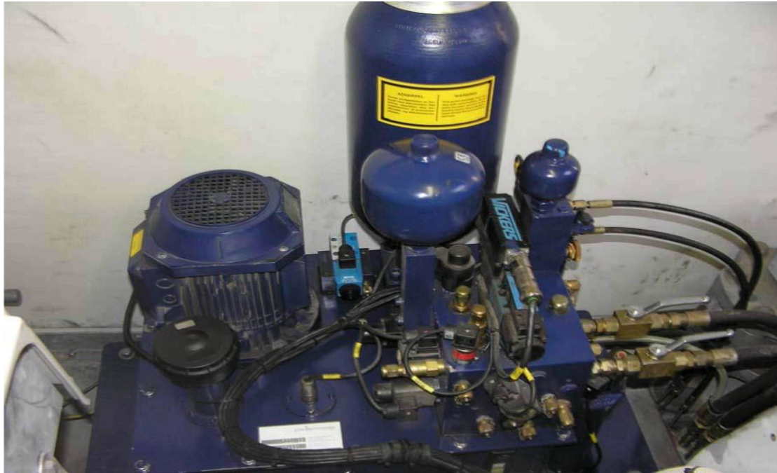
Σχήμα 3.15 Φωτογραφίες της αντλίας λαδιού τοποθετημένη στην ανεμογεννήτρια.[15]
