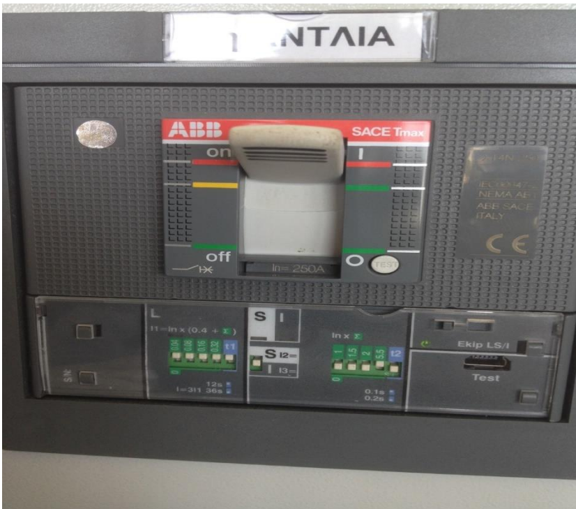
Εικόνα 28: Θερμομαγνητικός διακόπτης της αντλίας. Υπάρχει ένας για κάθε αντλία.
