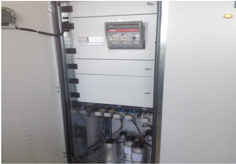
Εικόνα 29: Άποψη πεδίου πυκνωτών αντιστάθμισης.
