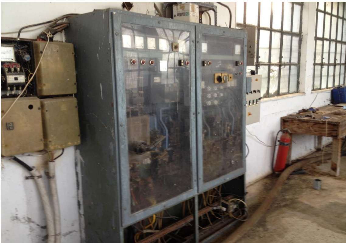
Εικόνα 21: Αποψη του παλαιού γενικού πίνακα χαμηλής τάσης
