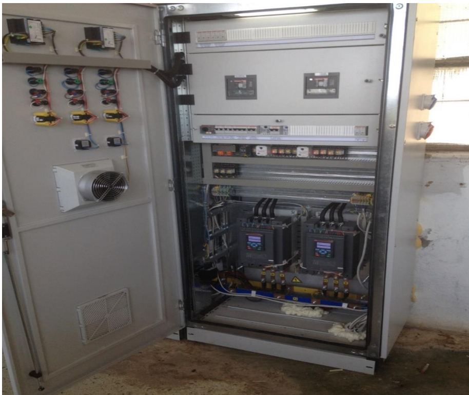
Εικόνα 26: Άποψη του νέου γενικού πίνακα χαμηλής τάσης
