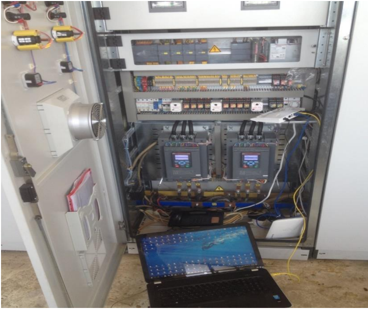
Εικόνα 27: Αποψη των ομαλών εκκινητών ( soft starter)
