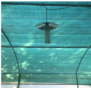
Εικόνα 2.18: Λαμπτήρες φωτισμού θερμοκηπίου
