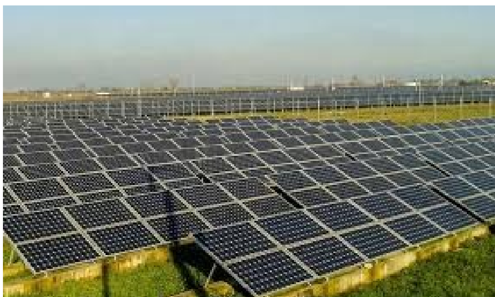
Εικόνα 2.6: Νέο φωτοβολταϊκό πάρκο στην Κύπρο.
