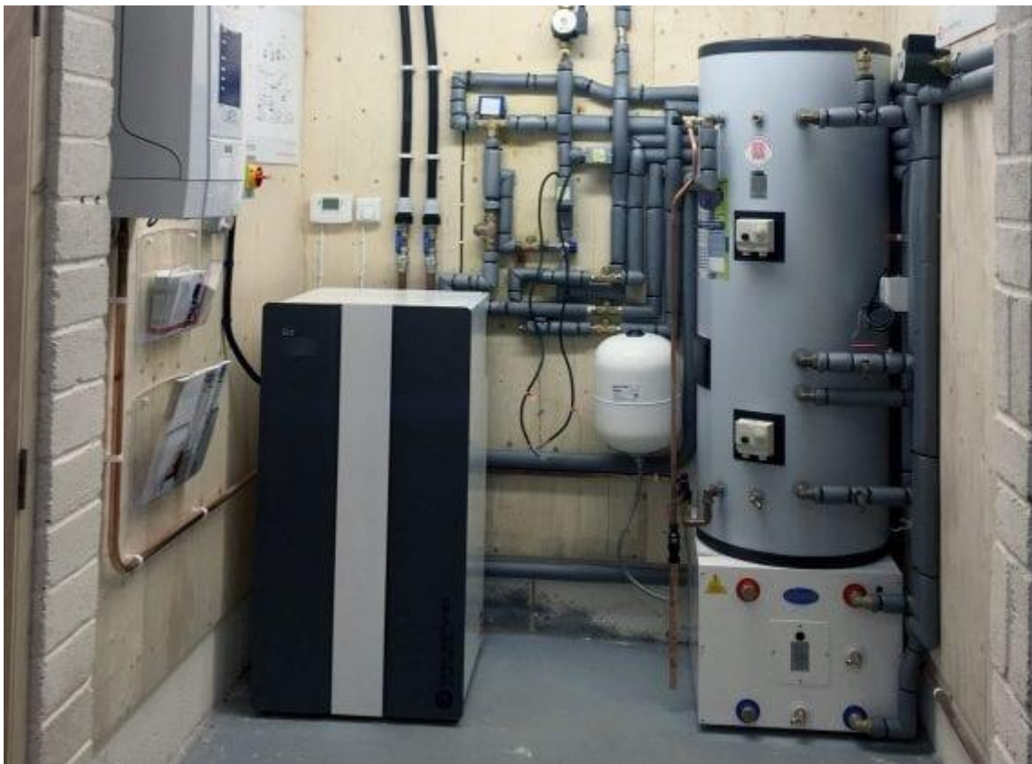
Σχήμα 4-6 Άποψη μηχανοστασίου συστήματος ΓΑΘ σε οικία.
