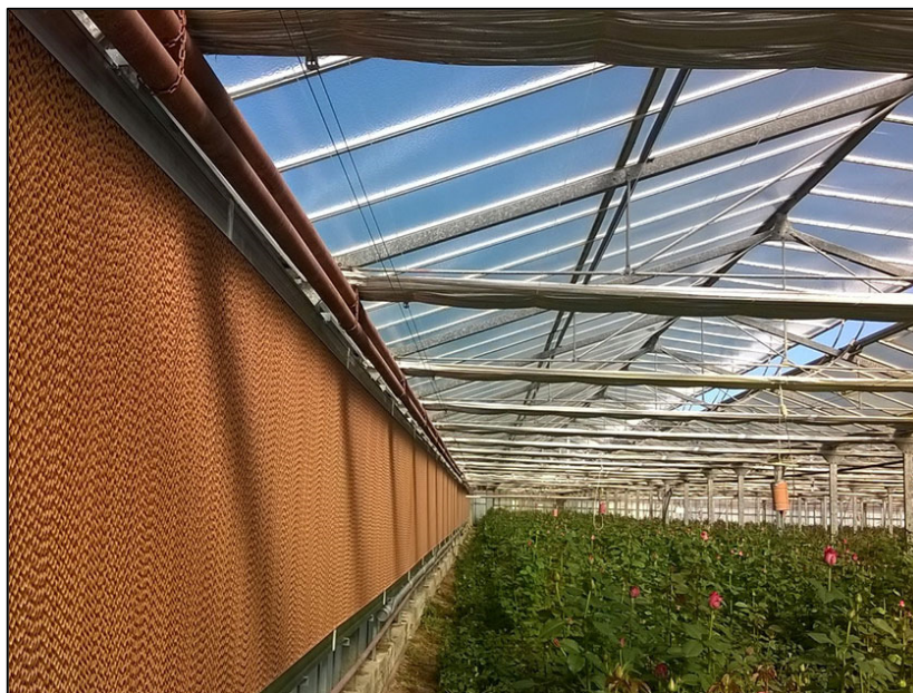
Εικόνα 8: Υγρό τοίχωμα (εσωτερική όψη).
