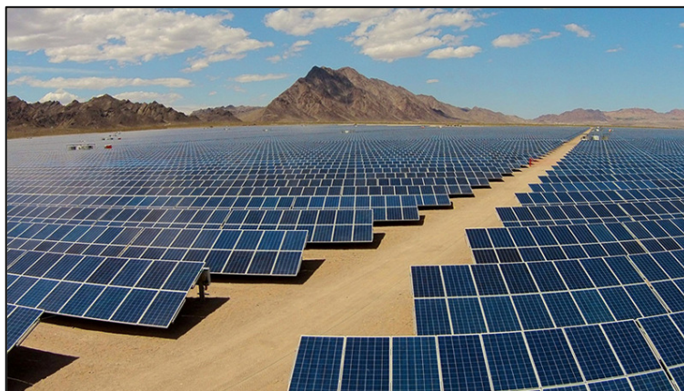
Εικόνα 14: Ηλιακή εγκατάσταση στο Copper Mountain, Nevada συνολικής ισχύος 458MW [24]
