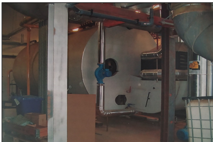
Εικόνα 3: Λέβητας παραγωγής ζεστού νερού. [5]
