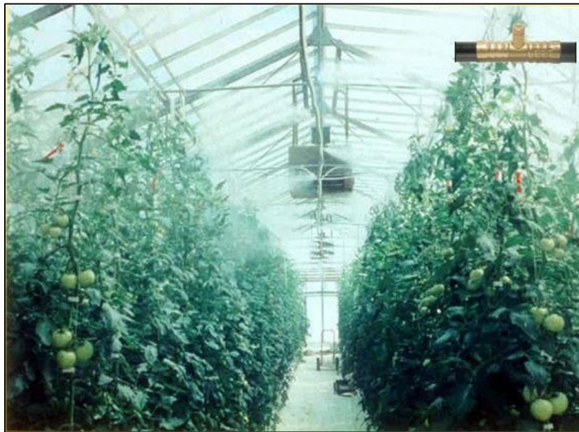
Εικόνα 9: Σύστημα υδρονέφωσης για ψύξη θερμοκηπίου. [14]
